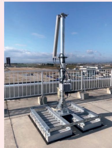
南蒲生浄化センター付近の海岸線約5kmにプライベートLTE網を構築
