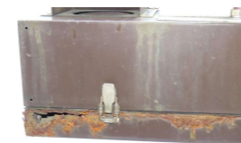
【道路情報板】 滞水による腐食
