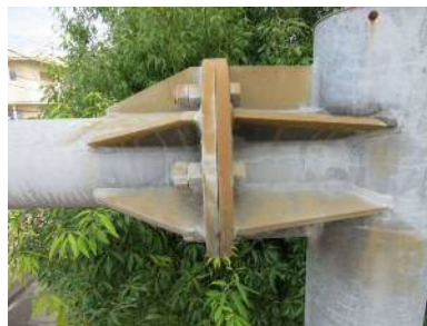
横梁仕口溶接部の腐食 【健全度：Ⅱ】
