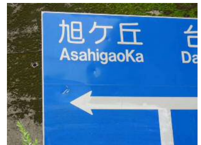
標識板の変形 【健全度：Ⅱ】
