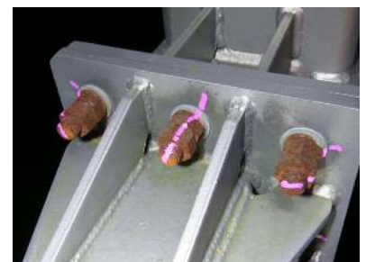
横梁取付部の腐食 【健全度：Ⅲ】
