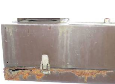
道路情報板の腐食 【健全度：Ⅲ】
