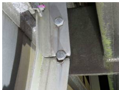
標識板取付部のき裂 【健全度：Ⅲ】
