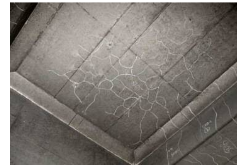
ひび割れ【健全度：II】
