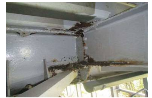
腐食【健全度：II】
