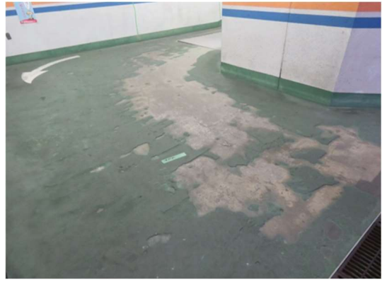
舗装の剥離【健全度：Ⅰ】
