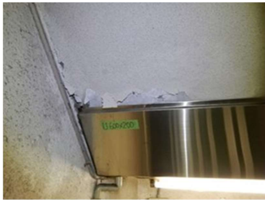
頂版のうき【健全度：Ⅰ】
