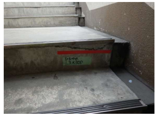
階段部のひび割れ【健全度：Ⅰ】
