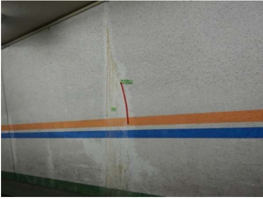
側壁のひび割れ・遊離石灰【健全度：Ⅱ】
