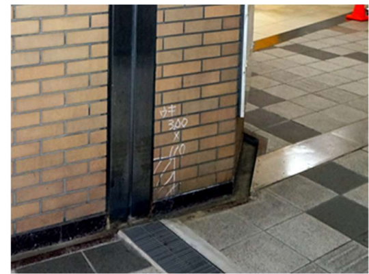
側壁タイルのうき【健全度：Ⅰ】
