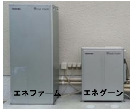
図 2-4 エネファーム及びエネグーン設置状況
