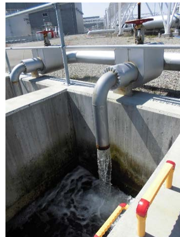
排水処理装置出口
