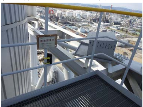
3-1 号煙突人工巢用赤外線カメラの設置 状況 (平成 28 年 4 月 14 日撮影)
