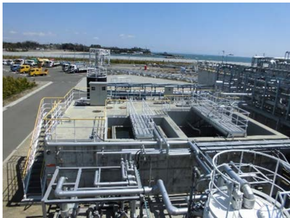
総合排水処理装置
