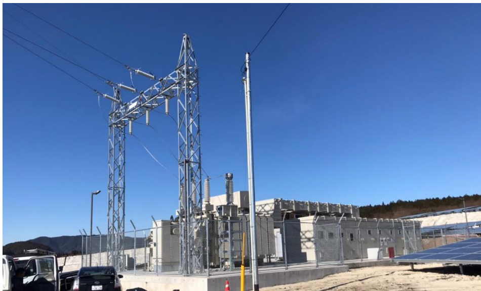
図 2.2-26 特高変電所のイメージ (写真)
