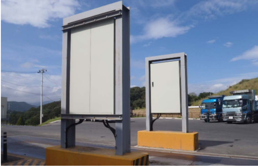
①トラックスケール(空間線量率計測機能付)
