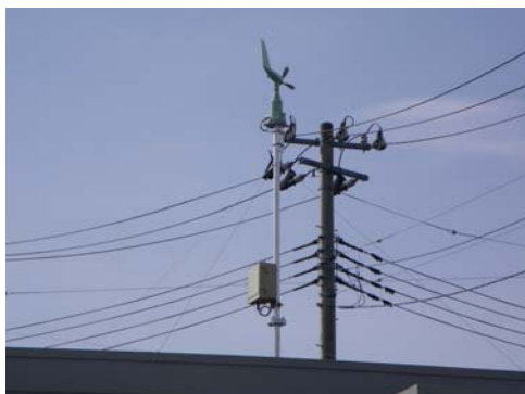
図 6-6 風向風速計設置状況 (平成 23 年 2 月 8 日)
