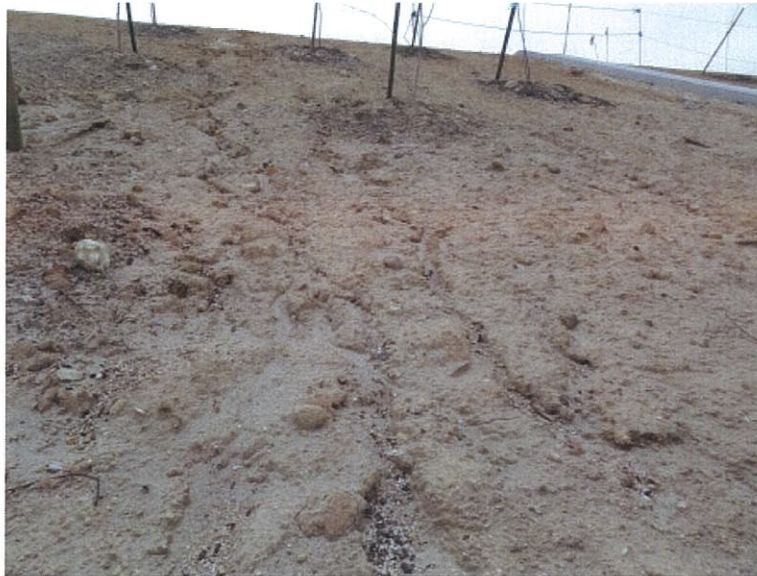
写真 7-6 盛土法面洗掘の状況 (平成25年4月16日撮影)
