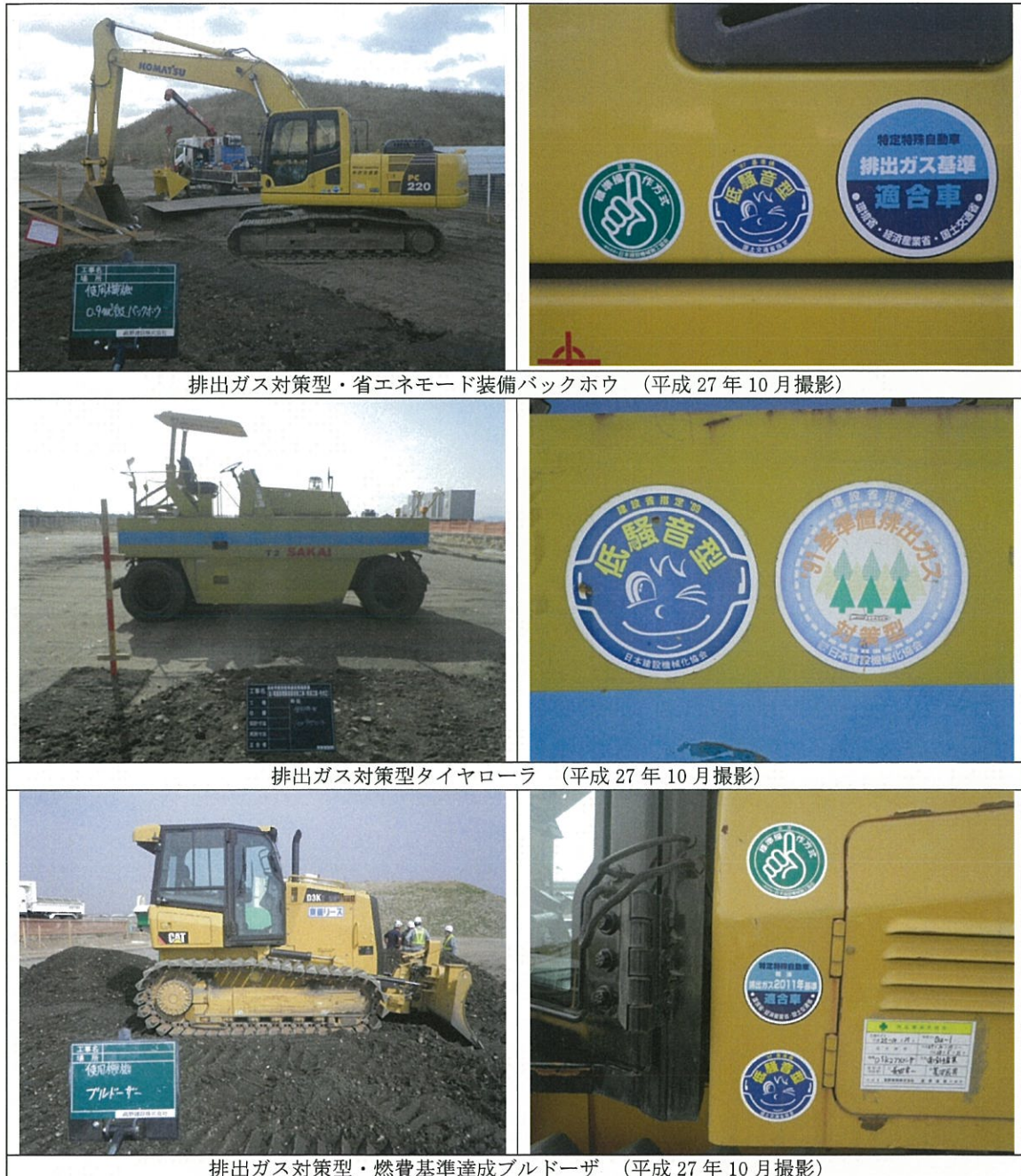
写真 8.6-1 排出ガス対策型・省エネモード装備・燃費基準達成建設機械の使用例
