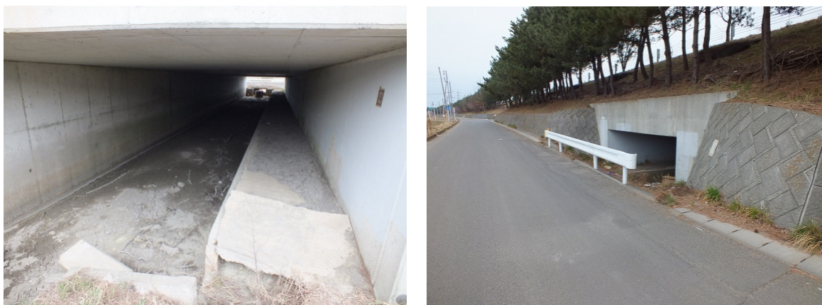
写真 8.10-6 幹線水路に設置するボックスカルバートの形状の事例
