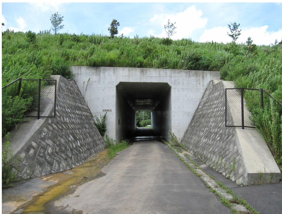
図 2.5-1 ボックスカルバートのイメージ (首都圏中央連絡自動車道[千葉県] 平成 22 年撮影)
