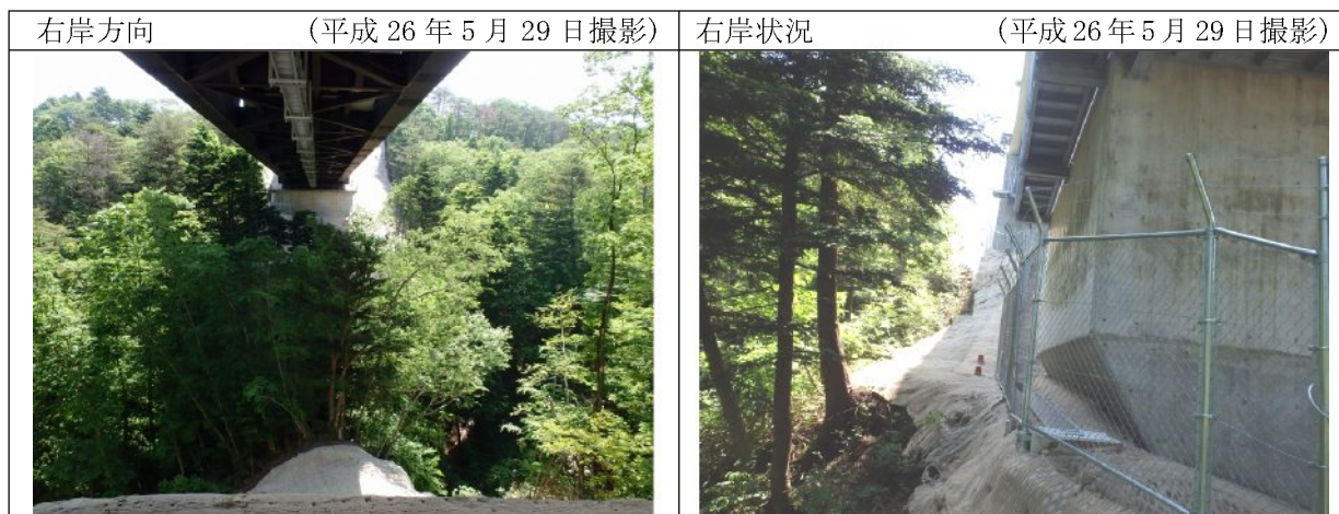
写真 6.1.1-2 右岸 竜の口溪谷急斜面の状況
