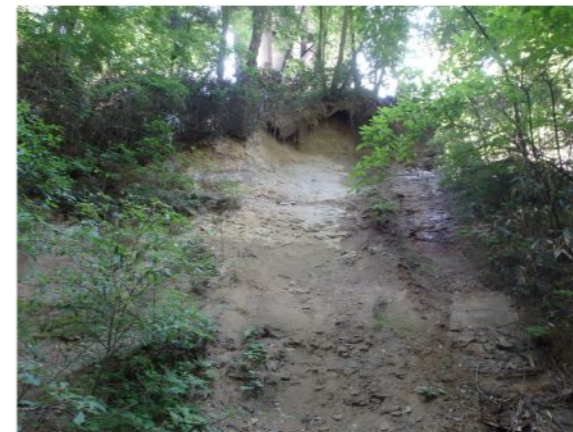
②右岸工事用地下端部の下 溪岸の状況 右岸斜面排水路より排水が行われているが、浸食等は生じていない。オーバーハングで不安定な地形だが新たな崩壊は発生していない(前回調査 H25.12.20 から変化なし)。
