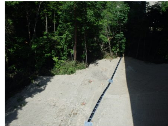
①右岸工事用地下端部 木柵と大型土嚢が撤去され、法面植生工により、溪谷への土砂流出を予防している(前回調査 H25.12.20 から変化)。
