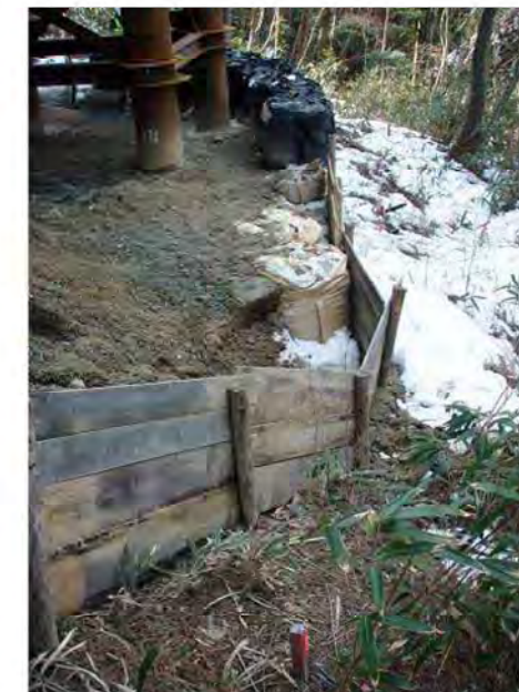
②右岸工事用地下端部 木柵と土嚢で工事の影響を最小限に留めている
