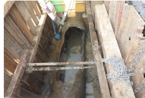
(腐食により破損した管路)
