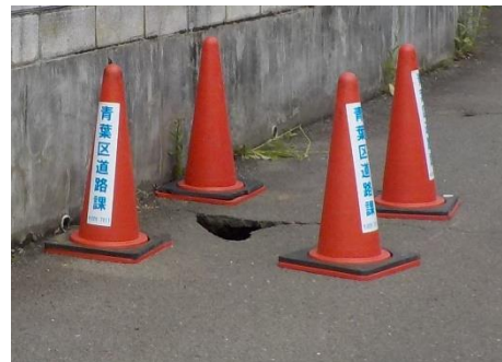
道路陥没の事例
