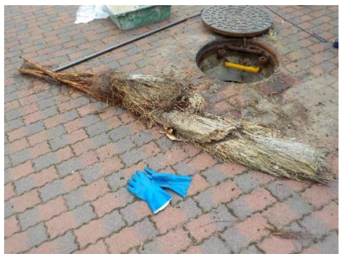
(管から除去した木の根)
