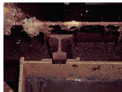
設備の腐食の状況
