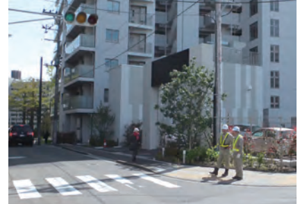
青葉通からの見え方に配慮した非常用電源
