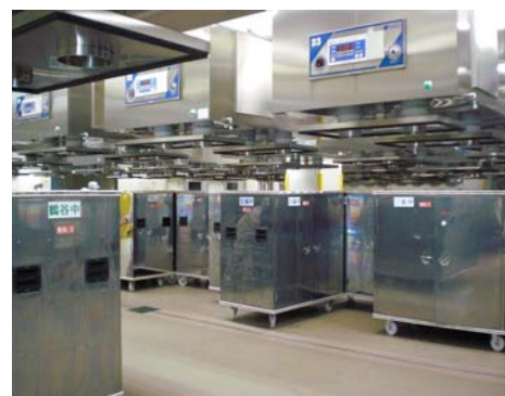
荒巻学校給食センター コンテナ消毒室 〈現在〉
