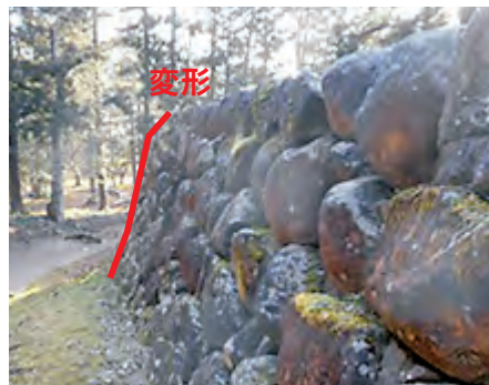
③変形した清水門石垣
