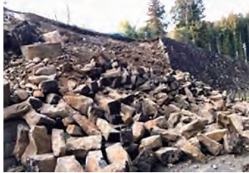
①崩落した本丸北西石垣
