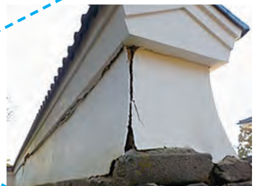
⑤大手門北側土塀の漆喰亀裂
