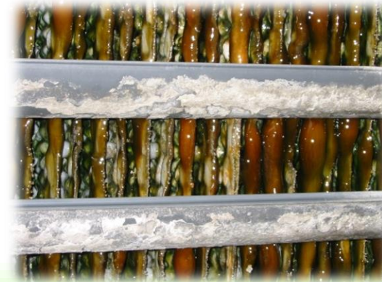
スケールがたまった冷却塔
