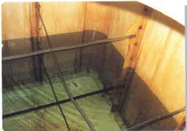
FRP製受水槽内のパネル締結ボルトの発錆
