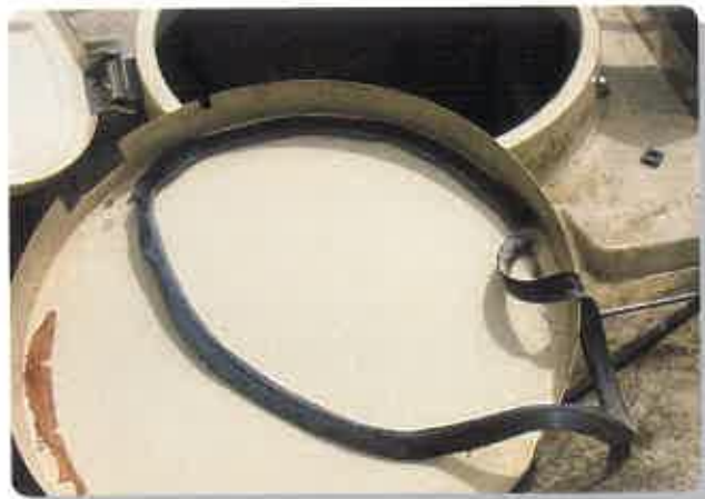
マンホール蓋パッキンの破損
