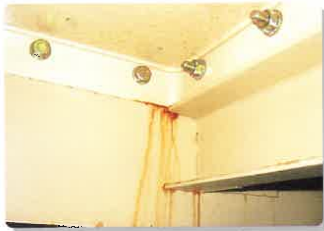
受水槽締結部から錆流出
