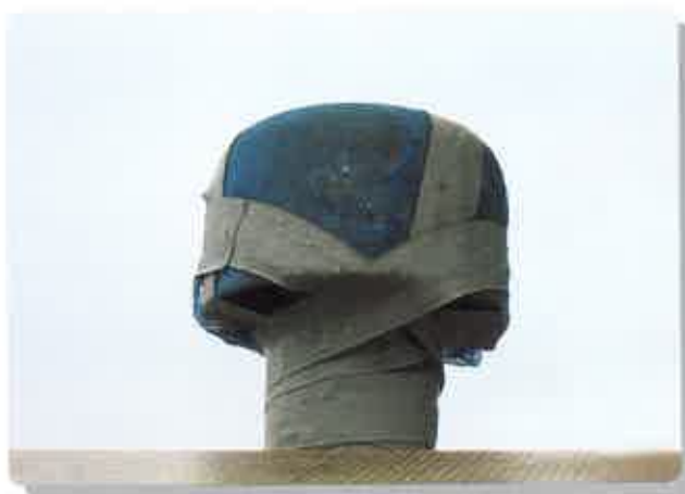
通気管防虫網の破損
