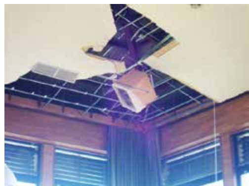
写真 非構造部材の被害例（榴ヶ岡市民センターにおける天井材の落下）
