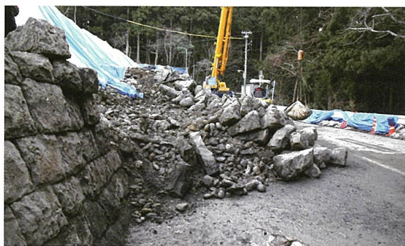
崩れた石のようす 上段の石材
