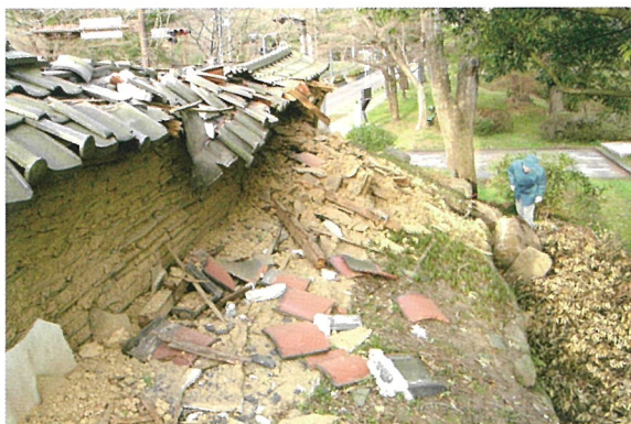
土塀西部の被災状況(東から)
