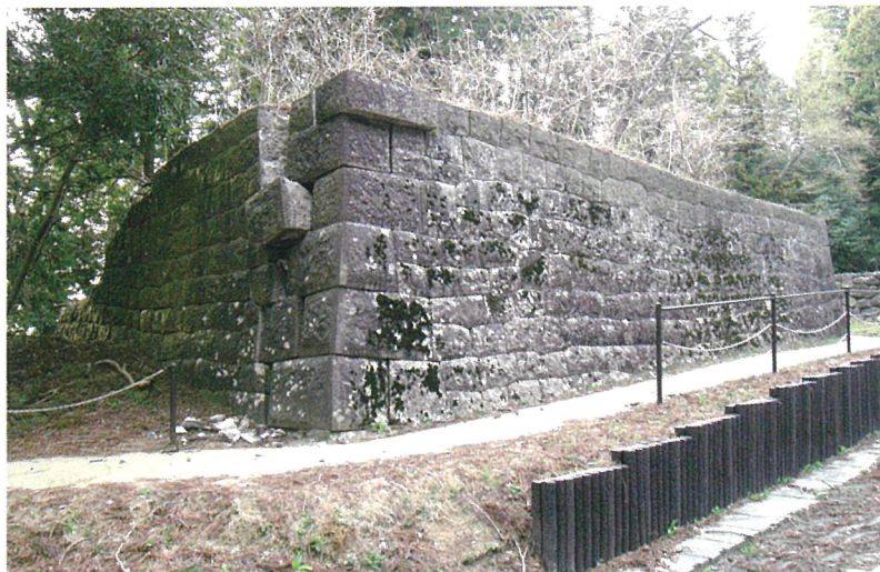
中門北石垣の被災状況 石垣の隅角部が大きくずれ、各面が前に傾いています。
