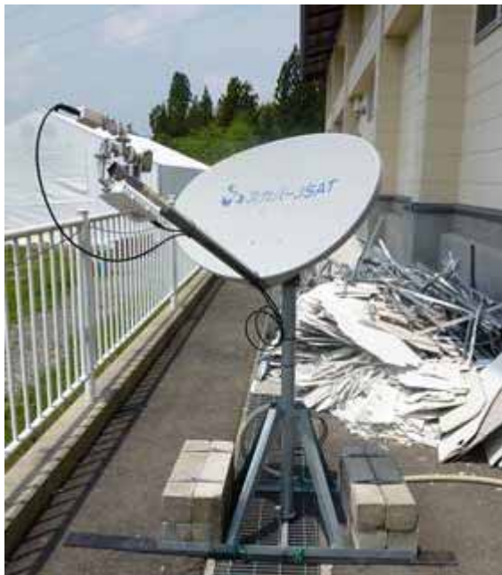
給食センター裏に設置されたアンテナ
