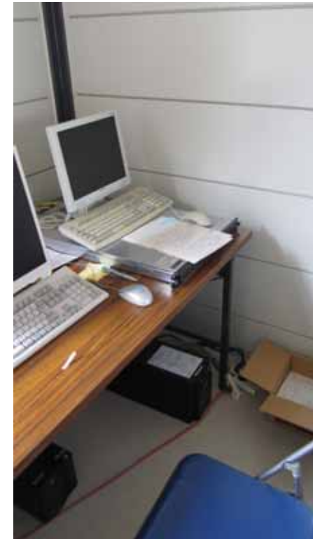
仮庁舎で稼働する住民情報システムの仮サーバー等
