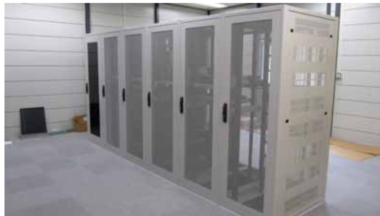
サーバー室のラック
