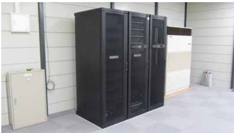
サーバー室の無停電電源装置
