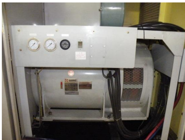
発電機(発電モーター)
