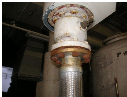
本庁舎機械室 揚水ポンプの状況
