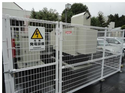
泉区の障害者福祉センターの自家発電設備の様子。
