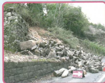
本丸北西石垣の被災状況 (平成23年3月)
