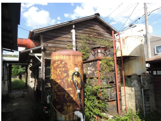
④ボイラー室
