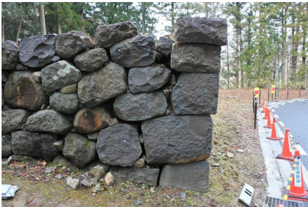
(国指定) 仙台城跡 中門南側石垣の積石ずれ
