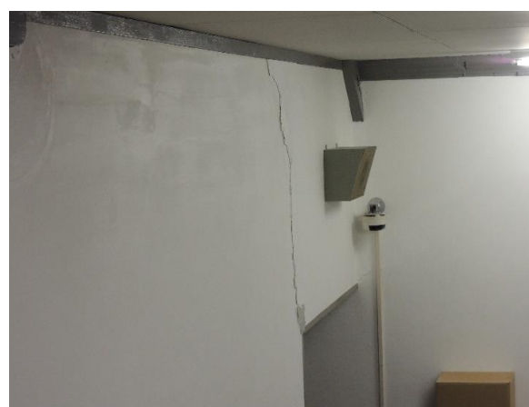
(市指定) 旧歩兵第四連隊兵舎 漆喰壁の亀裂・剥離
