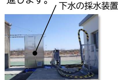
写真4 大学等研究機関への実験フィールドの提供 (南蒲生浄化センター)
