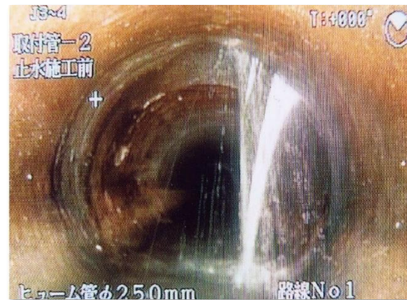
写真13 雨天時浸入水のカメラ調査 (再掲)
