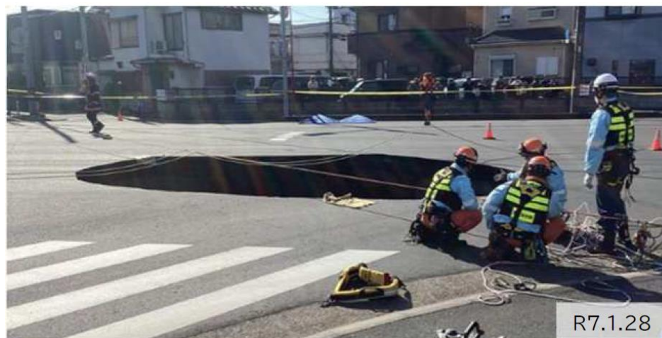
写真1 埼玉県の道路陥没事故（出典：埼玉県）
