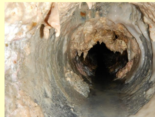
他の場所で発生した 下水道管の油脂（ゆし）詰まり
