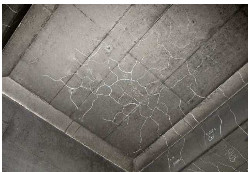
ひび割れ【健全度：Ⅱ】
