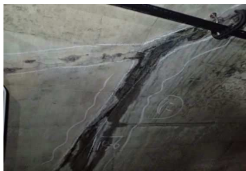
漏水【健全度：Ⅱ】
