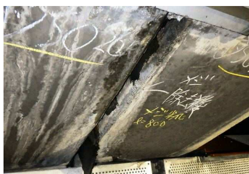
目地材の劣化【健全度：Ⅱ】
