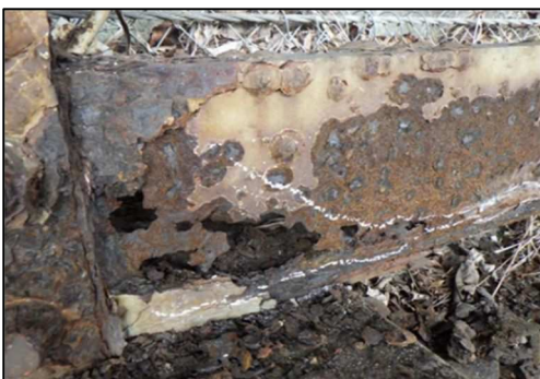
腐食、変形・欠損【健全度：Ⅲ】
