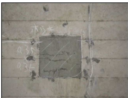
うき、ひび割れ
