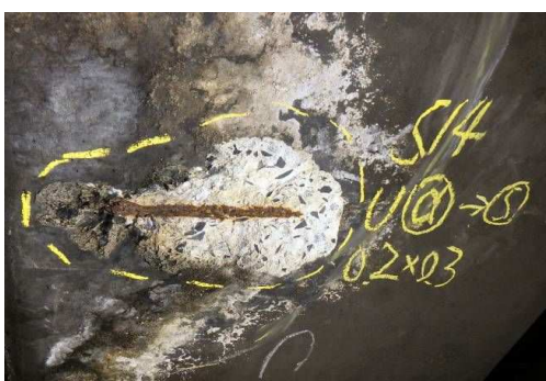
鉄筋露出【健全度：Ⅱ】
