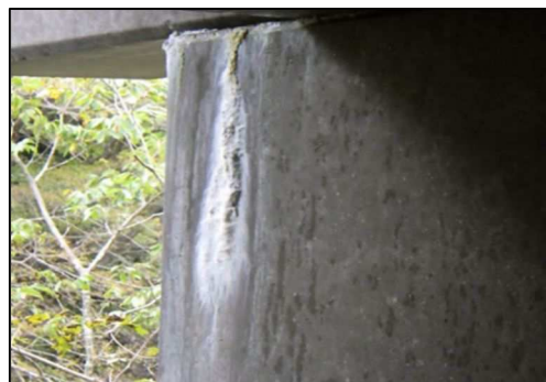
漏水・遊離石灰【健全度：Ⅱ】
