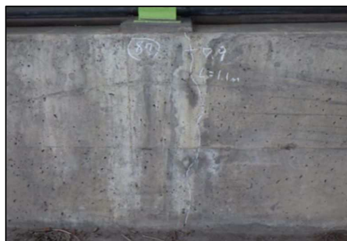
ひび割れ【健全度：Ⅱ】
