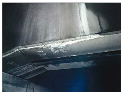
材質劣化、はく離
