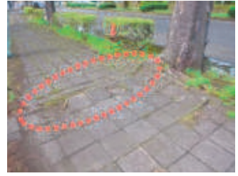
根上がりにによる舗装の隆起
