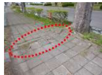
根上がりによる舗装の隆起
