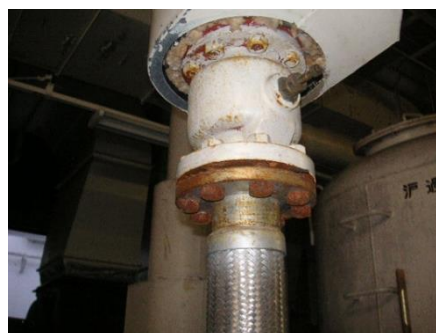
本庁舎機械室 揚水ポンプの状況
