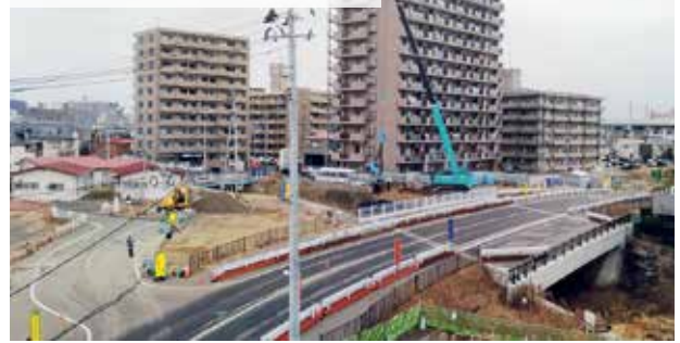
郡山折立線(大野田工区)
