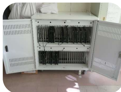
電源キャビネット
