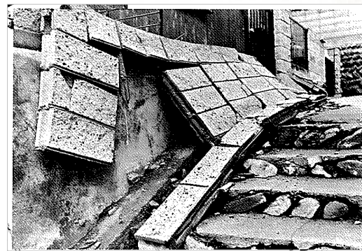
危険なブロック塀等
