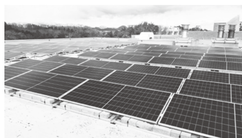
▲日立システムズホール仙台的太陽光発電設備
