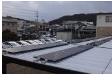
▲太陽光発電設備
