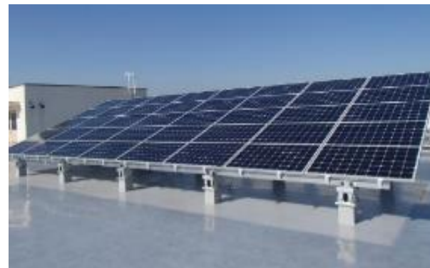
▲ 防災対応型太陽光発電システム
