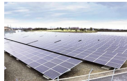
▲太陽光発電施設（地上設置）
