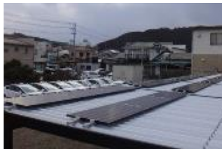
▲ 太陽光発電設備
