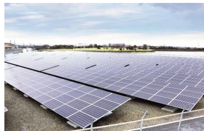
▲太陽光発電施設（地上設置）
