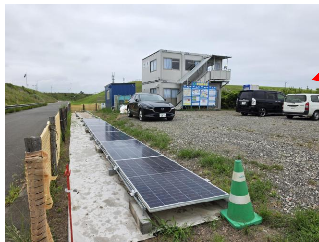
▲太陽光パネルの設置状況
