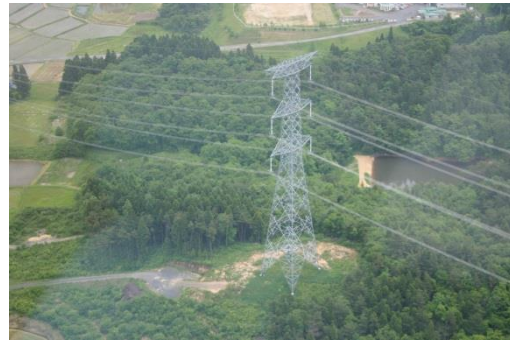
送電線を吊り下げている鉄塔
