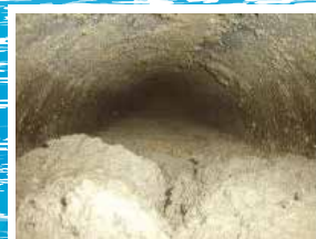
中で油が固まった下水道管
