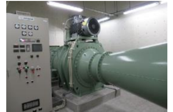
南蒲生浄化センターに設置している小水力発電機
